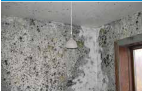
skn 7 Mögelpåväxt i vardagsrum efter vattenskada (foto - Protox)
