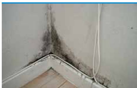
skn 5 Svartmögel i vardagsrum - uppkommet genom köldbrygga (foto - Protox)
