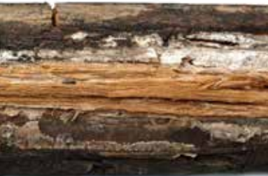
sv 28 Skinnsvamp (vitträta) i fönsterram (foto - Protox)
