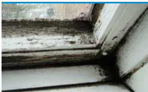
skn 4 Svartmögel på takfönster - bristfällig vädring (foto - Protox)
