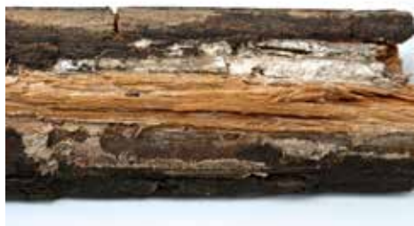
svn 53 Skinnsvamp i fönsterram (vitröta/röta) (foto - Goritas A/S)
