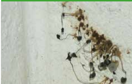
svn 19 Vedbläcksvamp - fruktkroppar på putsad vägg (foto - Goritas A/S)
