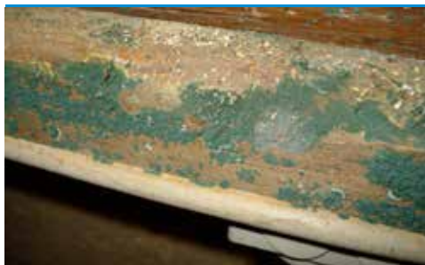
skn 2 Mögelpåväxt ( Trichoderma sp.) på brädfodring i vattenskadad krypgrund (foto - Protox)
