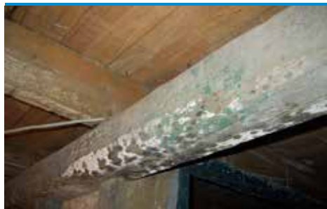
skn 1 Mögelpåväxt ( Trichoderma sp.) på vattenskadad balk i källare (foto - Protox)
