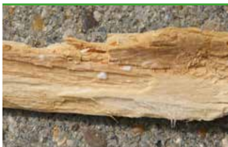
svn 39 Korkmussling i utväändig fasad. Notera små tussar av ytmycel på brytytor (foto - Protox)
