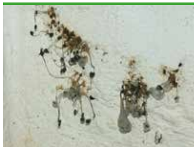
Vedbläcksvamp- torkade frukt-kroppar på putsad vägg (foto - Goritas A/S)
