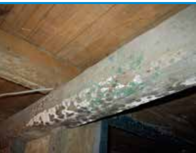
sk 1 Mögelangrepp - Trichoderma sp. i källarbalk efter rörskada. (foto - Protox)
