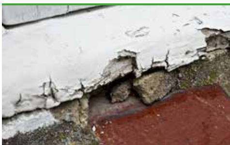
svn 58 Ytröta (gråmögel) - fönsterbleck på gammalt fönster (foto - Protox)
