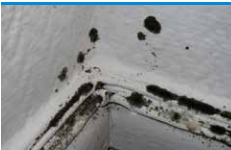
skn 11 Svartmögel på golvsoclel - bristfällig vädring (foto - Protox)
