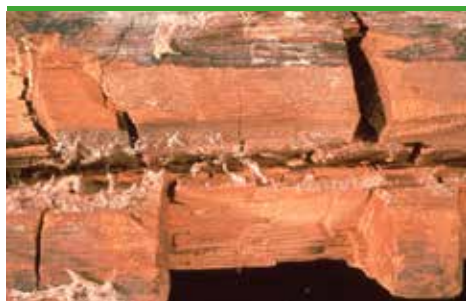
svn 49 Äkta Hussvamp - nedbruten träbalk. Brunröta med stora sprickklossar och ytmycel (foto - Protox/Gori A/S)
