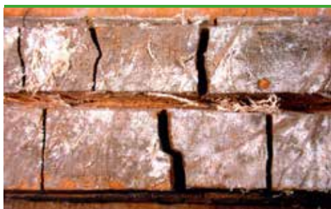
svn 50 Äkta Hussvamp- sprickklossar (foto - Hussvamp Laboratoriet)
